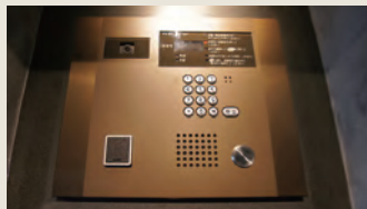
エントランスオートロック (ノンタッチ解錠)
